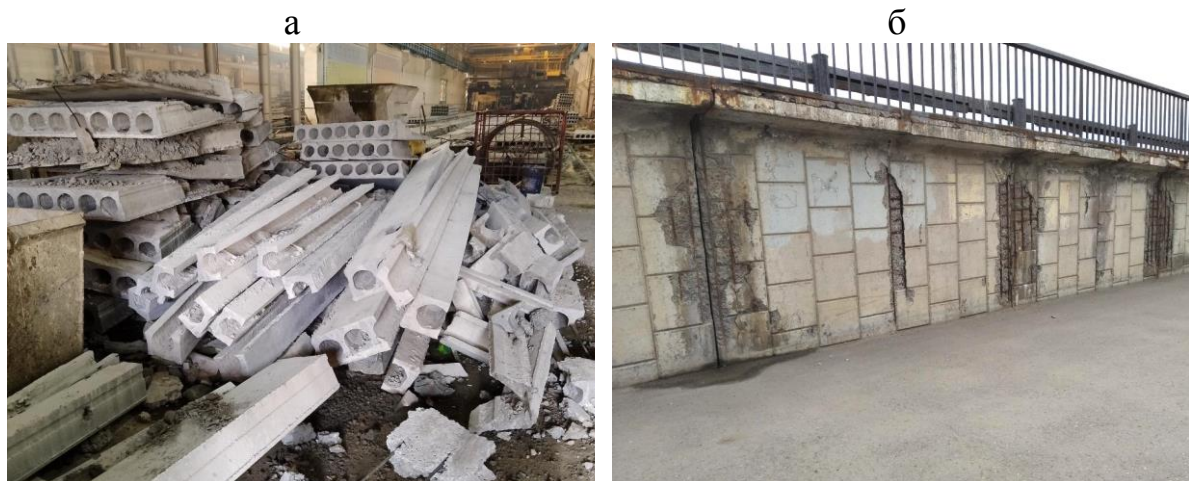
Рисунок 2. Брак и технологические отходы в цехе ЖБИ (а), морозное разрушение железобетонных конструкций моста (б)
