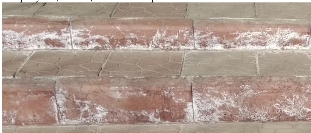
Рисунок 1. Высолы на поверхности ступеней из цветного бетона
